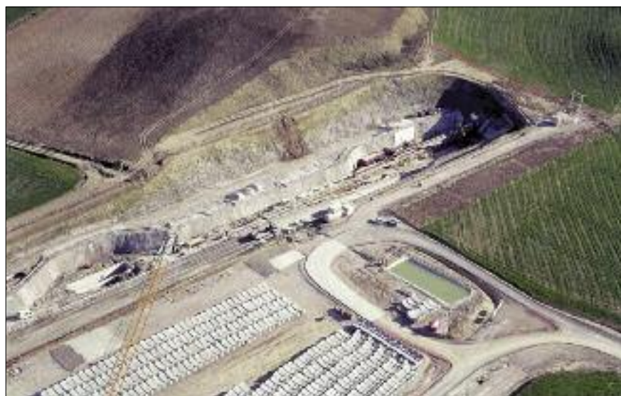
Tramo 2. Instalaciones túnel zabalceta.
