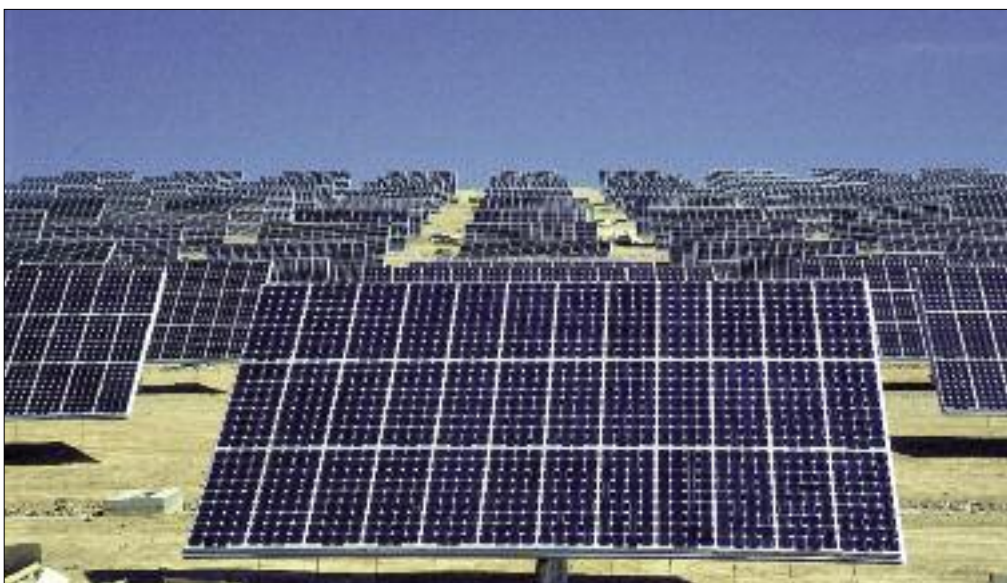
La planta solar fotovoltaica construida por EHN en Tudela es la mayor de España por potencia instalada.
